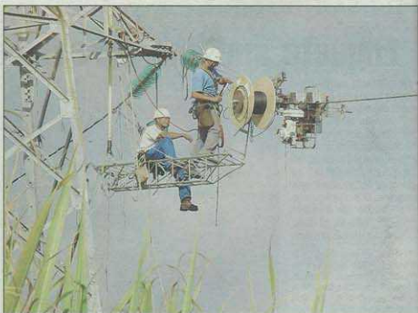
406 km de fibres optiques vont être installées autour des lignes haute tension d'EDF, ouvrant l'accès à l'internet très haut débit sur toute la réunionnais.
